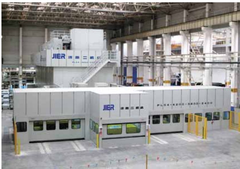
上汽通用烟台东岳项目双臂送料全自动快速冲压生产线
