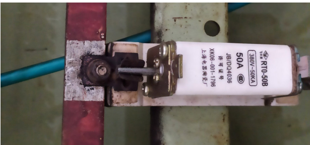
图1 熔断器接触不良
